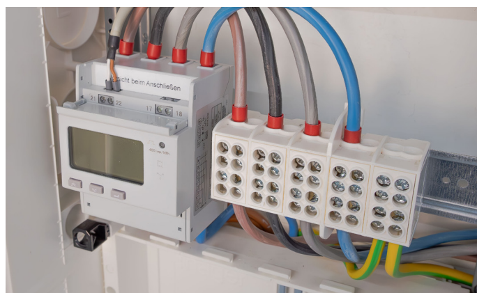
Abb. 36 ADL400 korrekt angeschlossen
